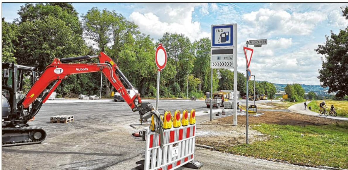
Noch laufen letzte Arbeiten an der Ansbacher Straße. Im Laufe des morgigen Mittwochs soll sie aber wieder für den Verkehr freigegeben werden. Foto: Jürgen Binder
