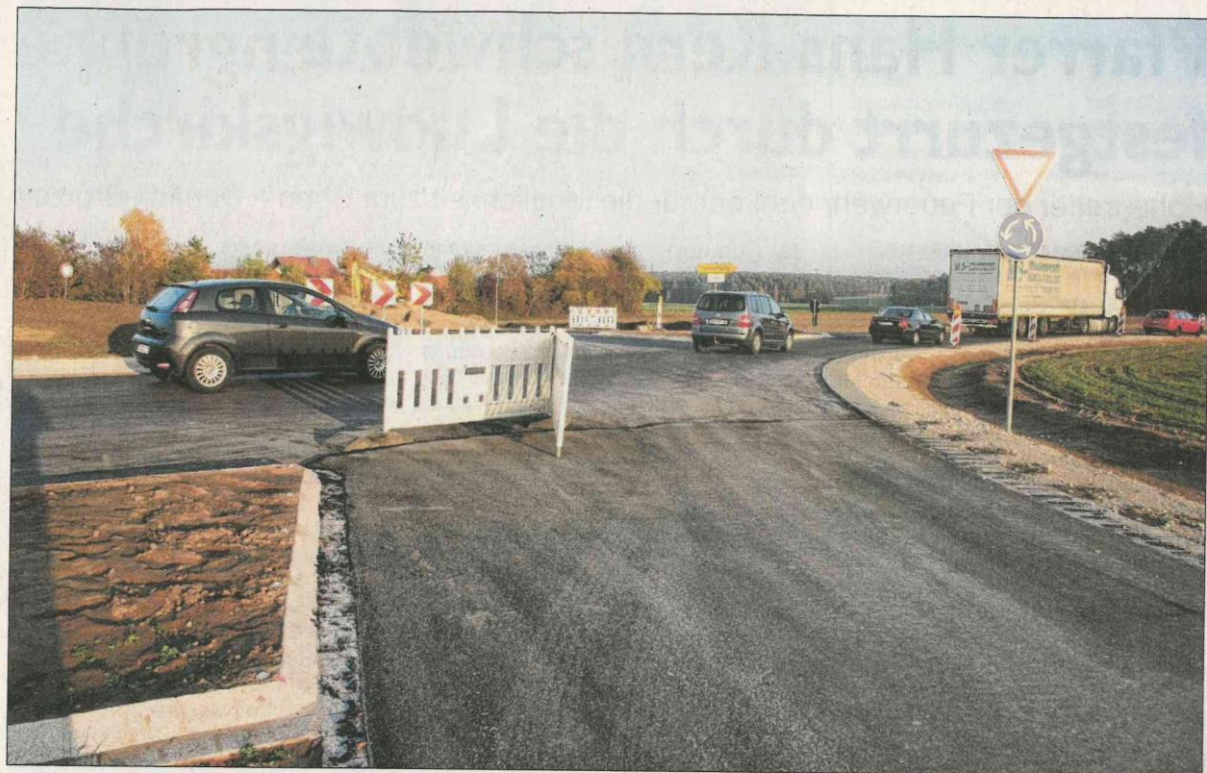
Der Kreisverkehr nahe der Ortschaft Haag ist schon stark befahren. In der kommenden Woche jedoch werden die Fahrzeuge umgeleitet, weil die oberste Asphaltsschicht aufgebracht wird. Foto: Eckard Dürr
